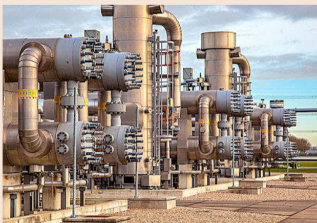
El gas natural es hoy fundamental para asegurar el suministro.
